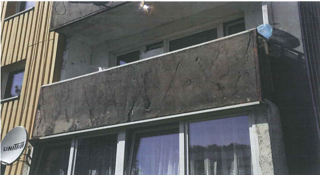
Fot.2. Widok na balustradę loggii – zły stan elementów metalowych, popękana balustrada betonowa.
