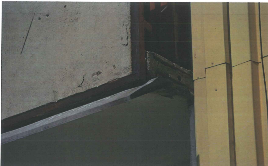
Fot.3,4. Detale płyt balustrad loggii – widoczna korozja elementów metalowych oraz płyty z widocznym zbrojeniem.
