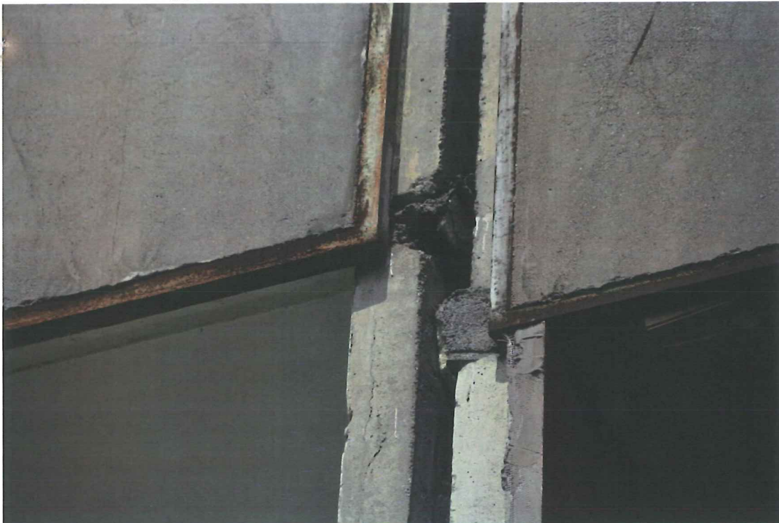
Fot.6. Detale płyt balustrad loggii – popękane płyty osłonowe ścianek.
