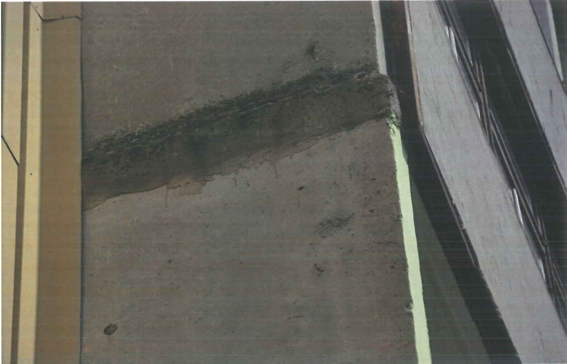
Fot.5. Ściana osłaniająca balkon –widoczne naprawy na połączeniu płyt.
