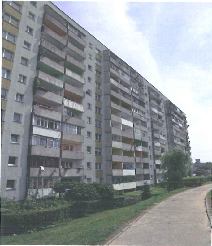
Fot.1. Widok na fragment elewacji z loggiami i balkonami- średni -zły stan techniczny większości balustrad
