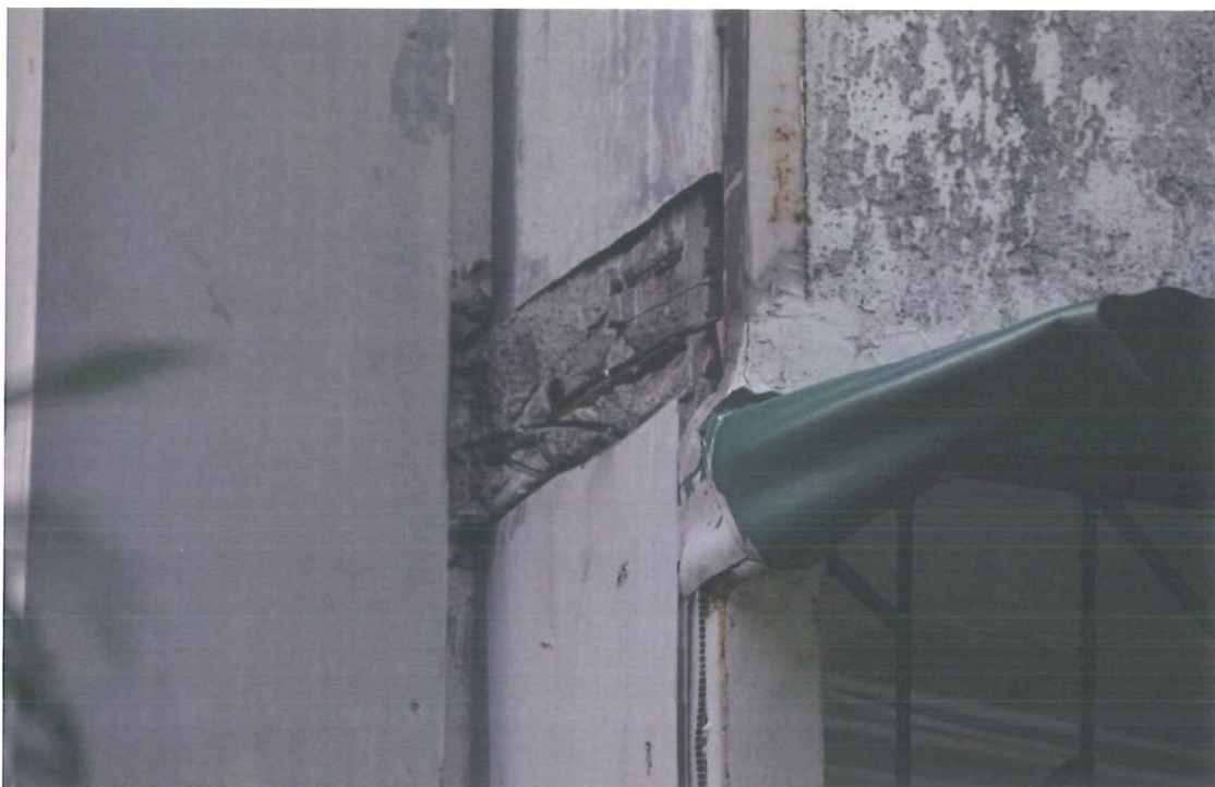
Fot.3. Detal loggii – widoczna korozja elementów metalowych oraz płyty z widocznym zbrojeniem.
