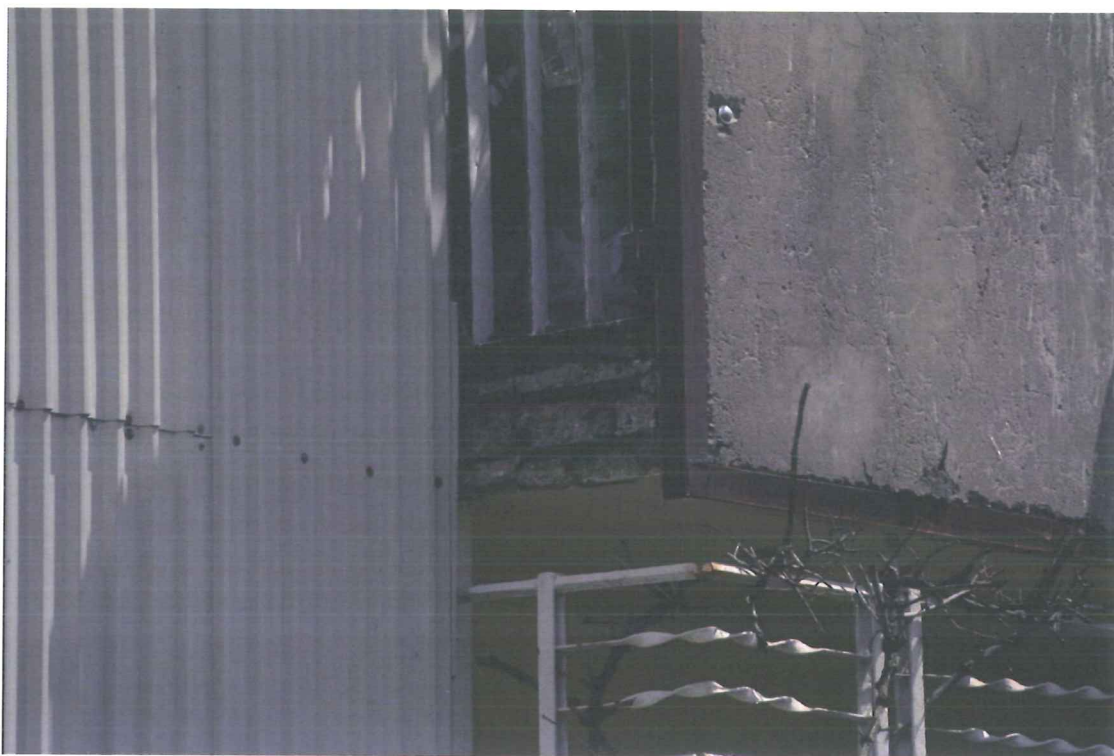
Fot.5. Detal płyty loggii – widoczna korozja płyty z widocznym zbrojeniem.
