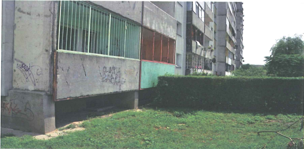
Fot.2. Widok loggii i balkonów- brudne ,zagłonięte balustrady loggii, skorodowane elementy metalowe.
