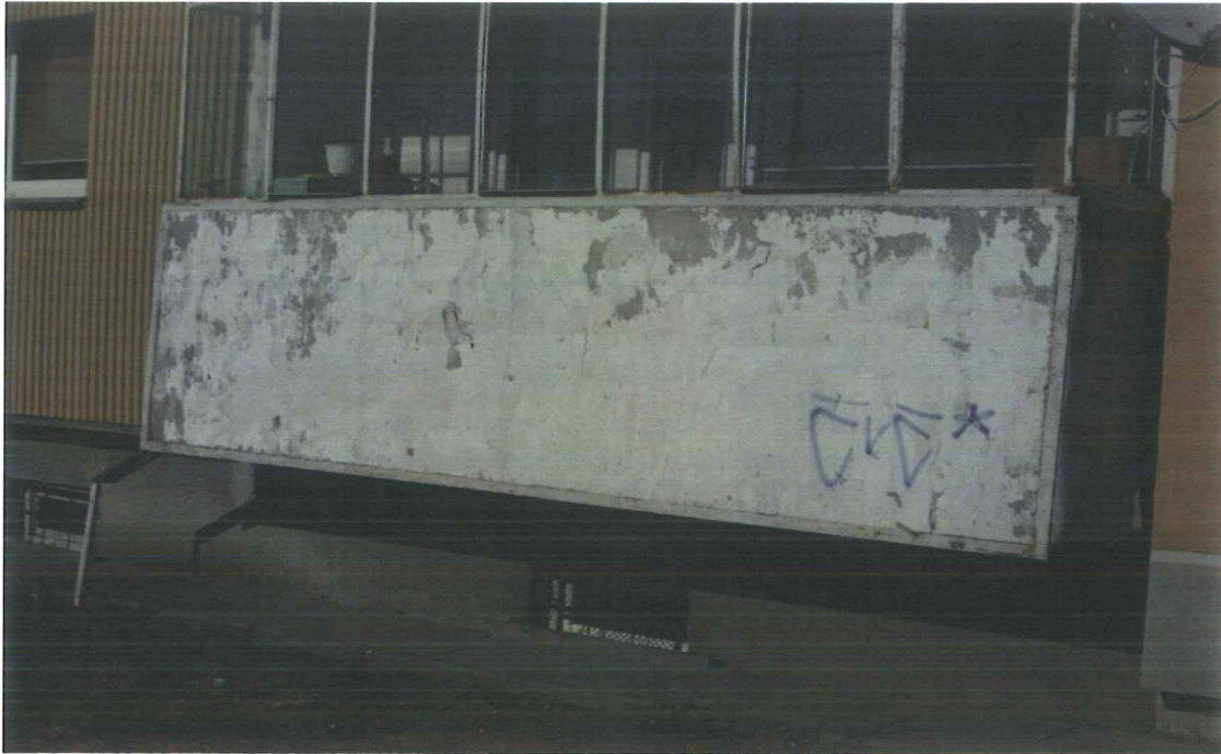
Fot.3. Widok loggii – brudne ,zaglone balustrady loggii.
