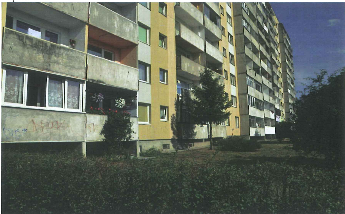
Fot.2. Widok loggii – brudne ,zagłonięte balustrady loggii
