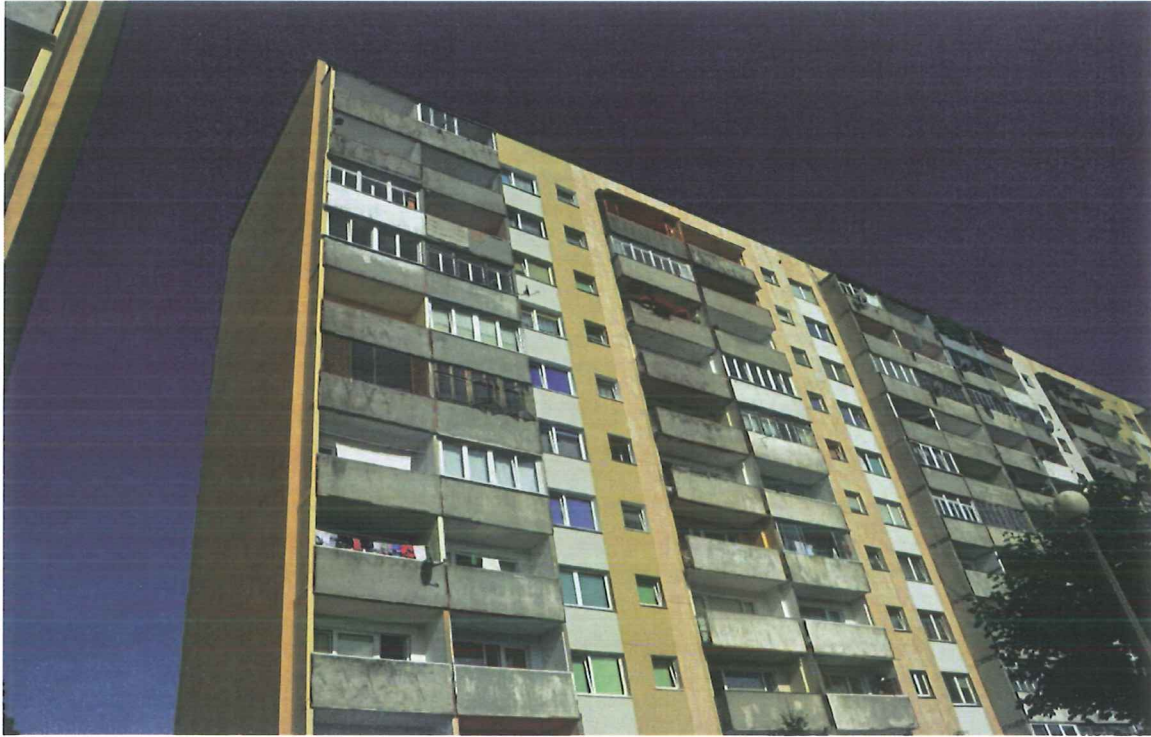
Fot.1. Widok na fragment elewacji z loggiami i balkonami- średni -zły stan techniczny większości balustrad
