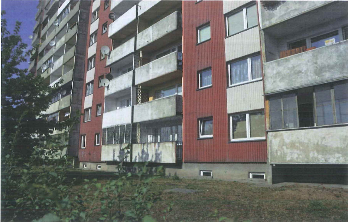
FOT.1. Widok na fragmenty elewacji z loggiami i balkonami - średni stan techniczny
