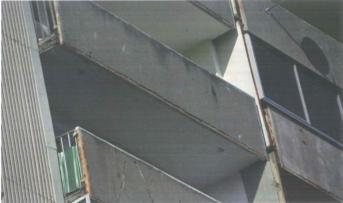
Fot.3. Widok płyty loggii– ubytki w płycie, nieestetyczny wygląd.
