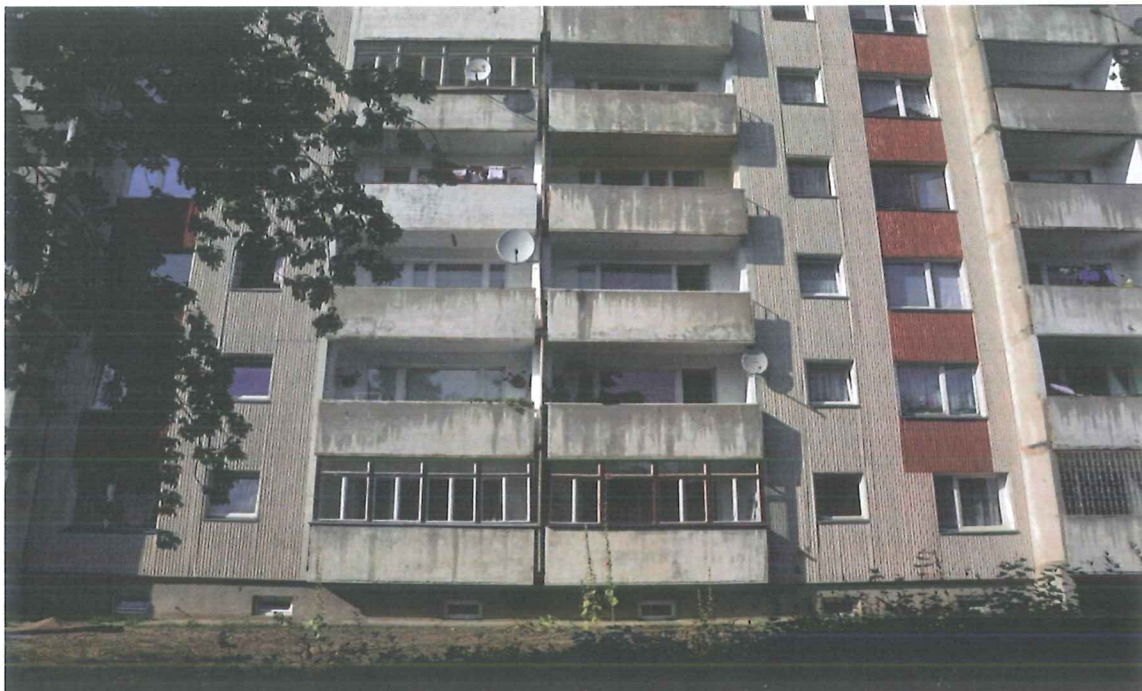
Fot.1. Widok na fragment elewacji z loggiami i balkonami- średni -zły stan techniczny większości balustrad
