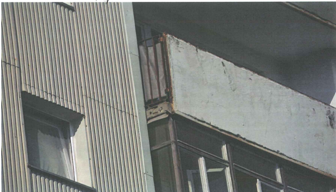
Fot.2. Widok loggii – widoczna korozja elementów metalowych oraz płyty z widocznym zbrojeniem.
