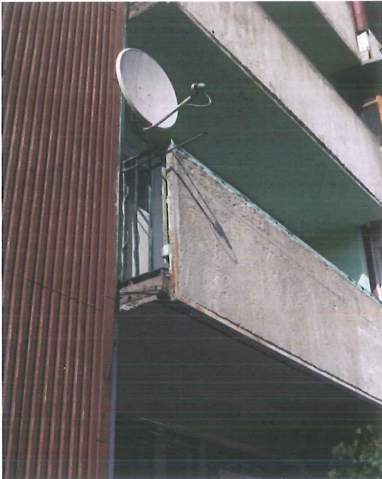
Fot.4. Widok loggii –korozja elementów metalowych oraz płyty z widocznym zbrojeniem.
